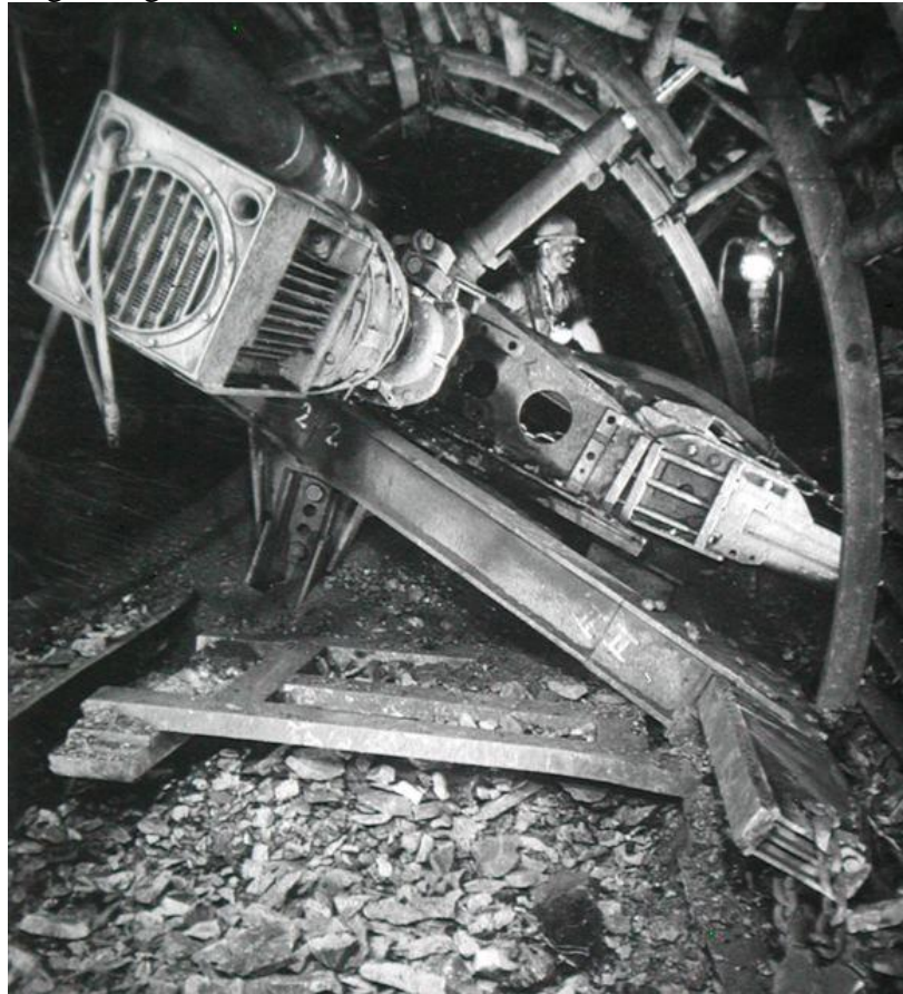
Antrieb eines Rammgerätes auf der Kopfstrecke. Inbetriebnahme am 16.10.1958
